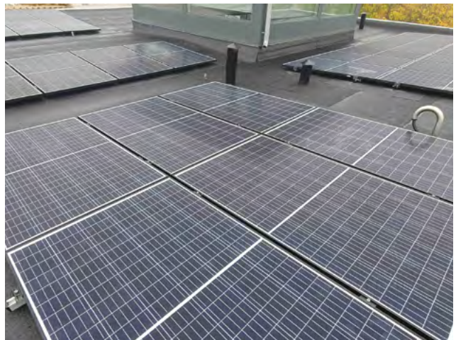
Svanhalsgenomföring på platt papptak. Bildkälla: https://varmitek.se/32-stycken-solceller-pa-papptak/ (2022-04-22)
