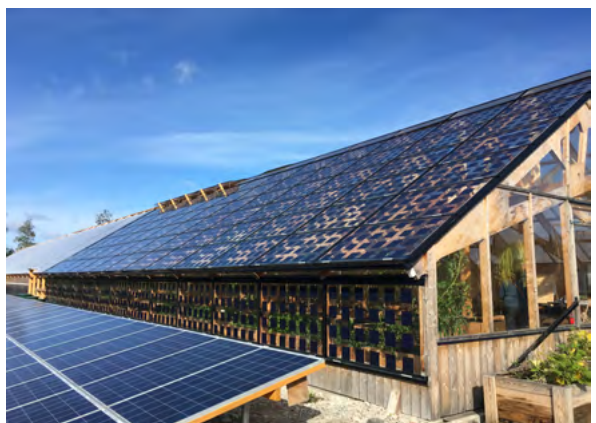
Växthus med semi-transparenta solcellspaneler integrerade i tak och fasad. Plats: ETC, Katrineholm Katrineholm. Bildkälla: WSP.
