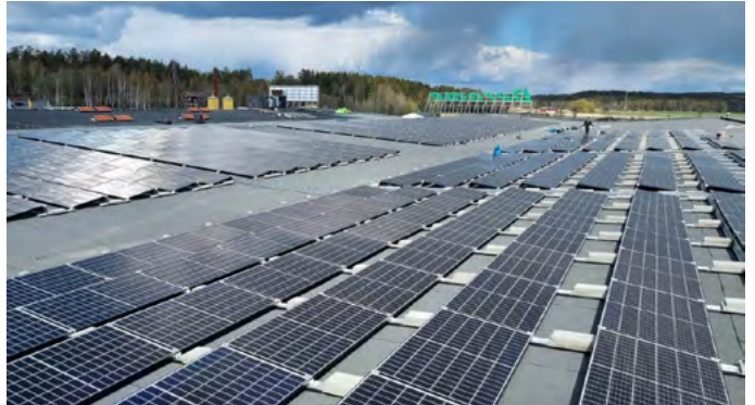
Ballastsystem för att förankra solcellsinstallation Bildkälla: https://paneltaket.se/referenser
