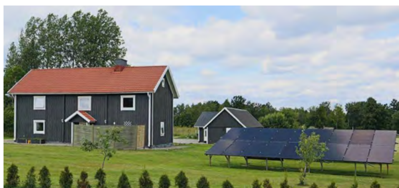
Mindre markbaserad solcellsanläggning på villatomt.
