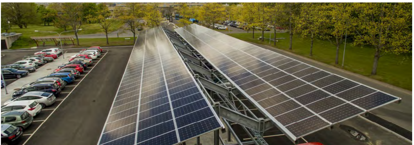
Solceller som tak ovanför parkeringsplatser, Skaraborgs sjukhus. Bildkälla: Skaraborgsbygden
